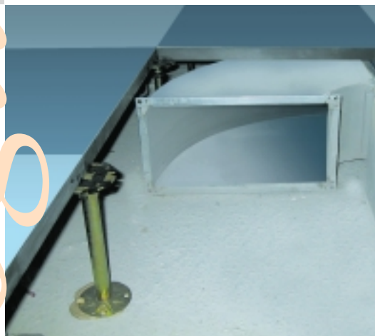
Unterflur-Führung eines Klimakanals. Offengelegtes Koppelungsstück.
